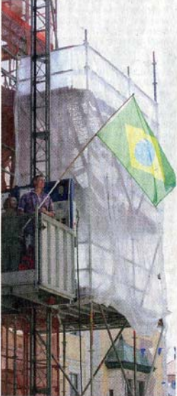
Brasilienfans unter den Bauarbeitern am Pfeifturm: Sie hissten gestern schon mal die Flagge des südamerikanischen Landes.
